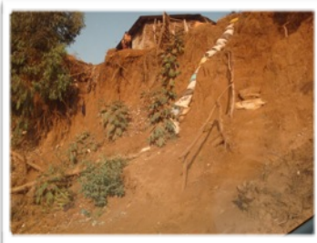
... ce qui engendrent effondrement, glissement de terrain ... accidents et misère !
